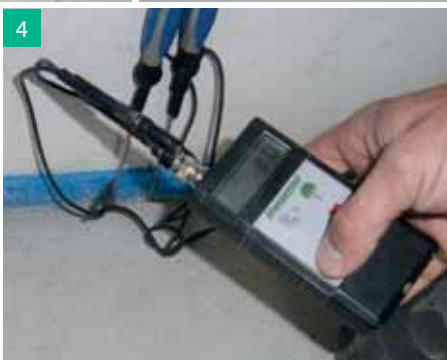
1 Feuchtemessung untere Estrichdämmung im Wohnzimmer: 19,9 °C; 90% rF.
